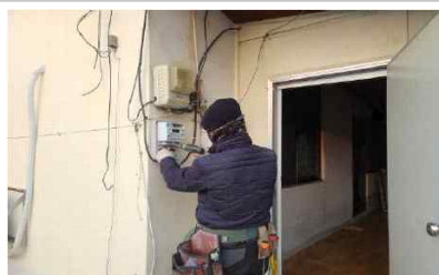
<개별 전력량계 설치>
