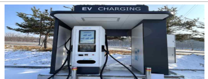
전기자동차 충전 인프라 구축
