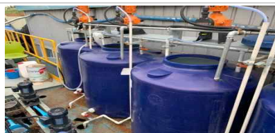
<폐수처리시설 교체 및 개선 지원>
